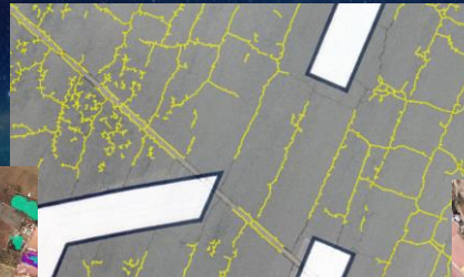
Detección de grietas en la carretera
